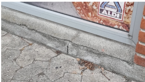
Revner i sokkelpuds ved Aldi
