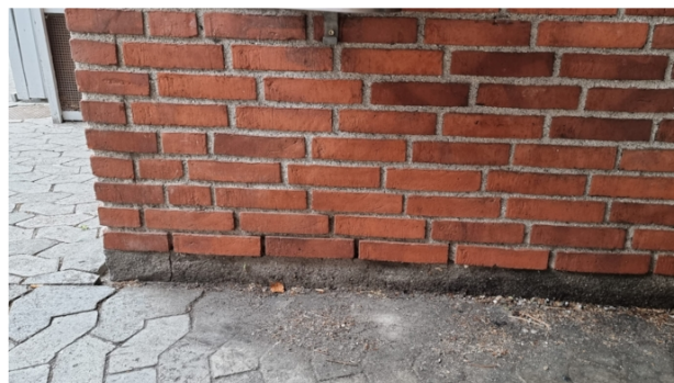
Udvaskede fuger ved gennemgang, sandsynlig årsag: saltning.
