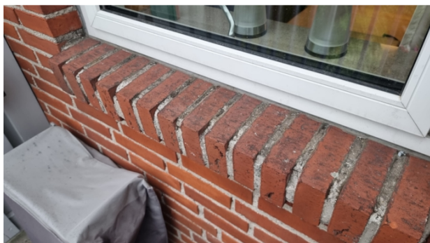
Sålbenk med udvaskede fuger.
